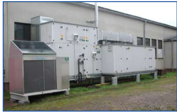
Klimaanlage der Mischerei im Außenbereich
